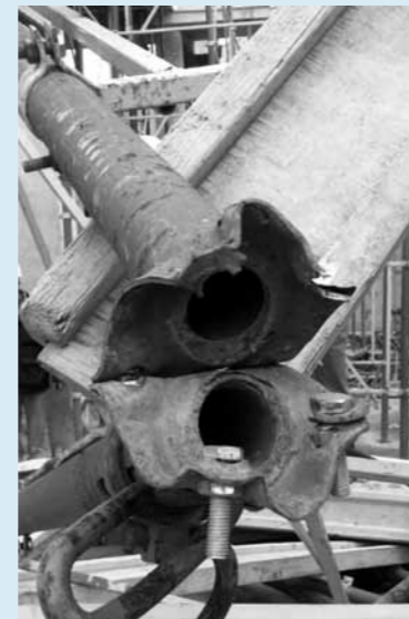
Рис. 7. Разрушение спаренной стойки в зоне фланцевого соединения при потере ей устойчивости
